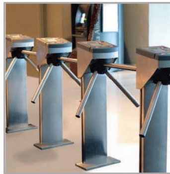
CONTROLES DE ACESSO
